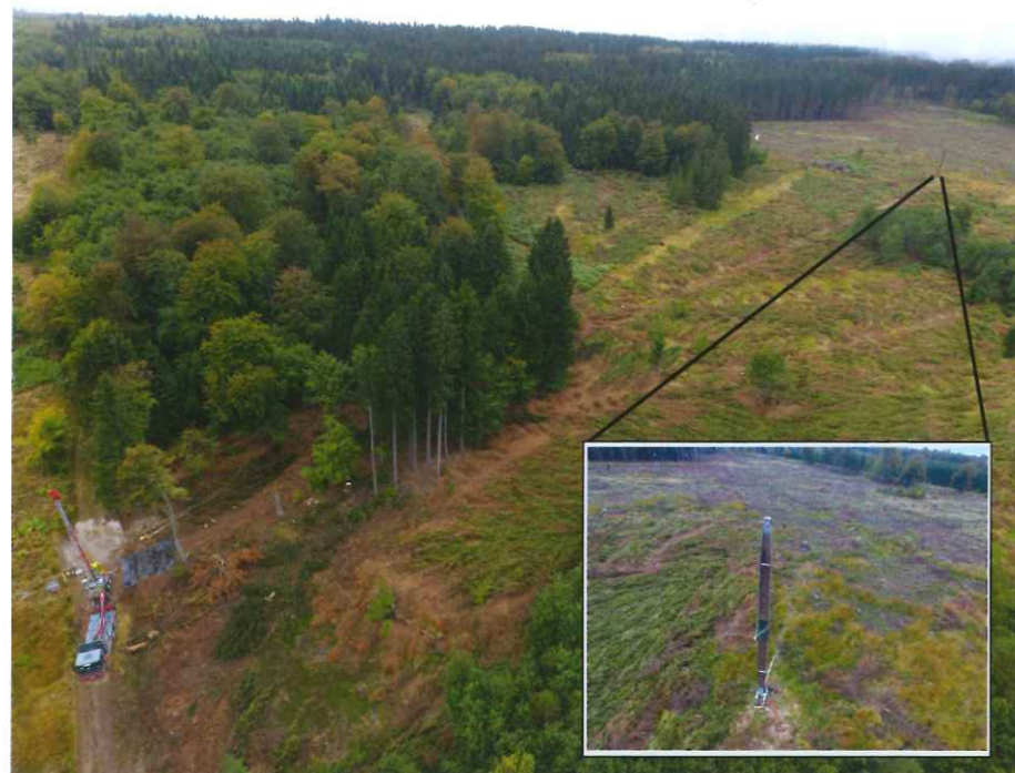
Luftbildaufnahme des Flachlandseilkran am Casparsbruch im Nationalpark Hunsrück-Hochwald. Die Aufnahme wurde von einem UAS aufgenommen und zeigt die 400 Meter lange Seiltrasse, ausgehend vom 17 Meter hohen Seilkran, der mit vier Abspannseilen stabilisiert wird. Der Seilkran dient in diesem Fall zur Bringung von Fichten unter 25 Jahren, welche in Bündeln schwebend zum Ablageplatz transportiert und dort verladen werden. Auf diese Weise wird eine bodenschonende Bringung der Fichten gewährleistet. Die Detailansicht zeigt den ebenfalls 17 Meter hohen Mast, der aufgrund fehlender Stützbäume eingesetzt wird.
